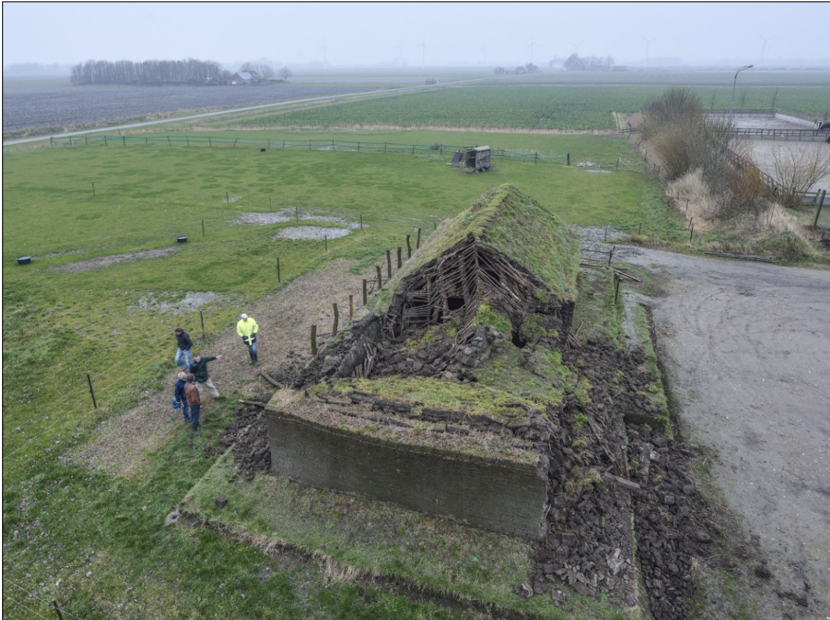
De schade wordt opgenomen na de instorting.
