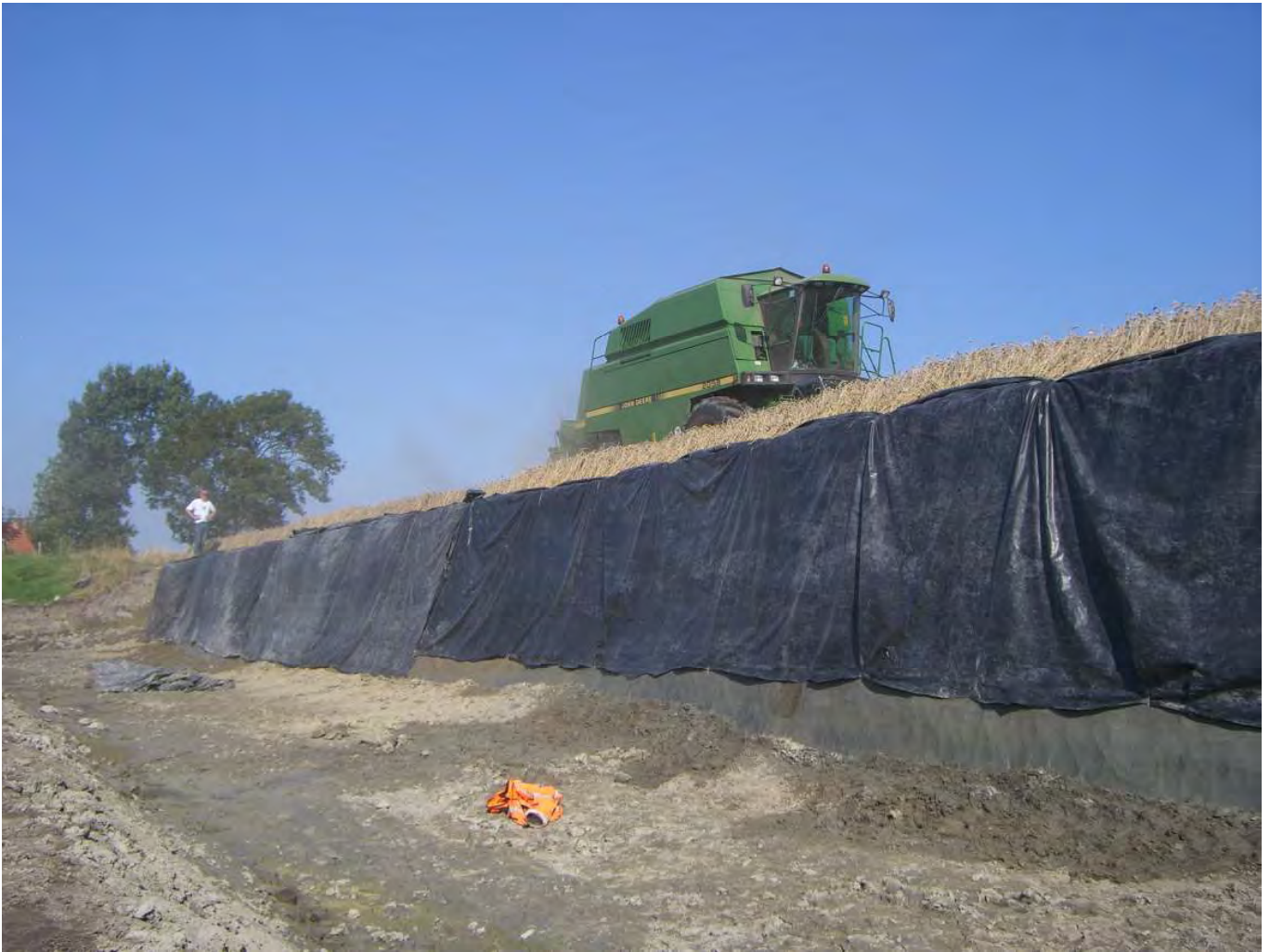
Anjum, 11 september 2006, 15:29. Een spannend moment. Een 12 ton zware combine naderde in snel tempo het talud van de steilkant om alle tarwe te kunnen dorsen. Gelukkig scheurde het profiel nergens. De honderden meters landbouwplastic bleken de sporen in het profiel bovendien niet alleen goed te beschermen tegen water en zon, maar ook tegen een grote hoeveelheid dorsstof.
